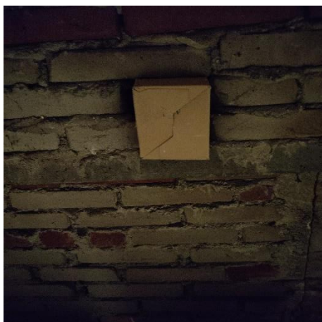
Figuur 9 Groot warmtelek op zolder bij een doorvoer zijgevel
